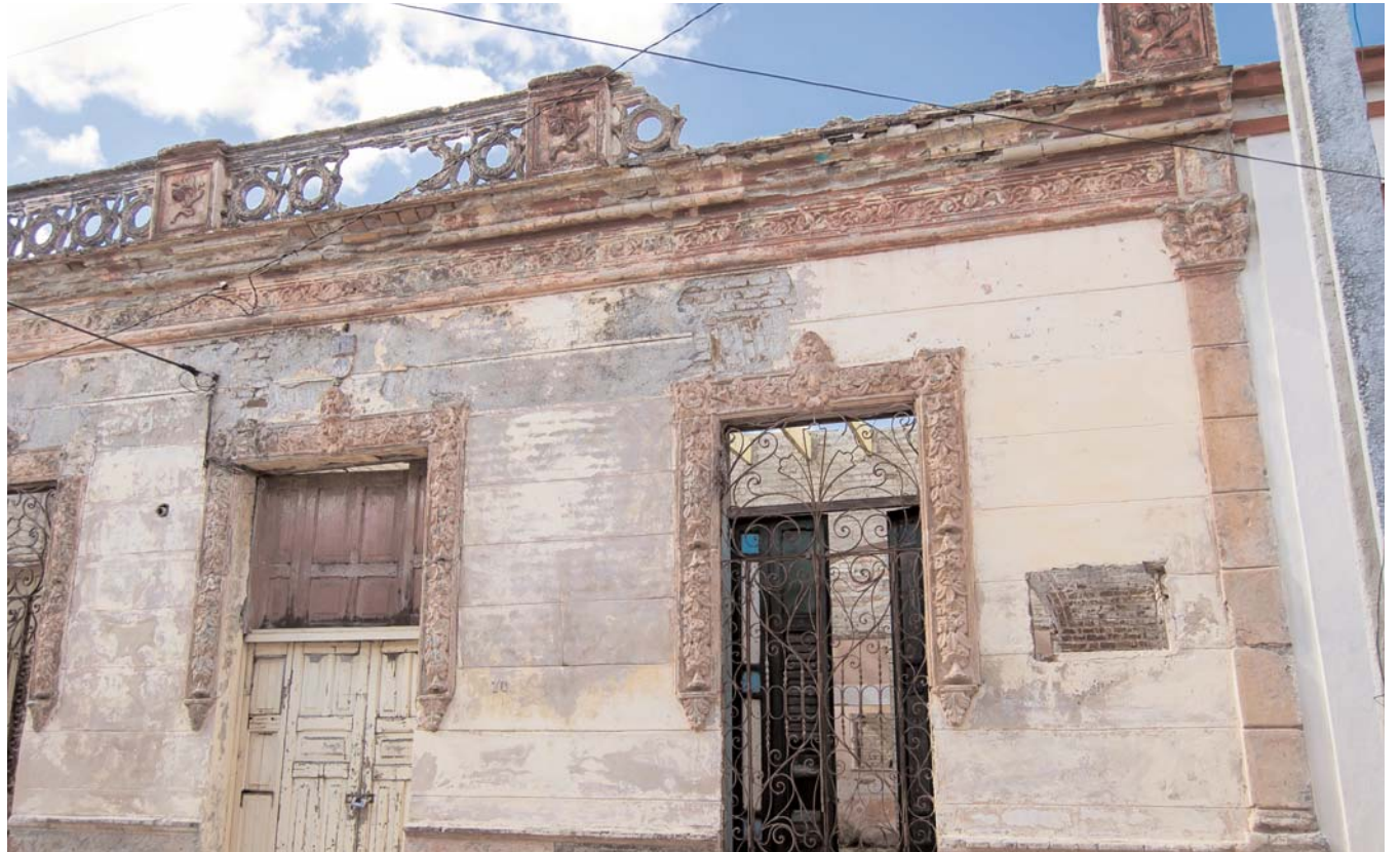
Inmueble con valor patrimonial, situado en la calle Mártires, acentúa su deterioro por demoras burocráticas.
